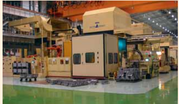
Rauchabsaughaube „Ultravent“ mit Filteranlage auf Gießmaschinen im Hyundaiwerk in Südkorea.
